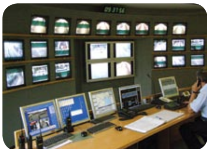
Sustav automatske detekcije incidenata (AID)
