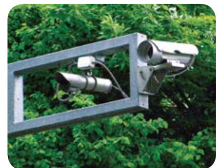
Kamera na portalu tunela Učka
