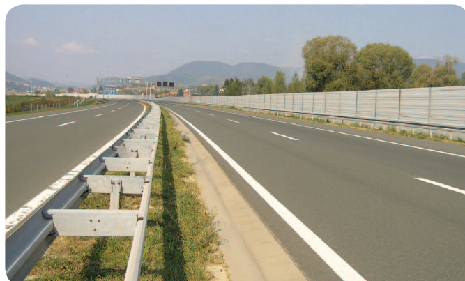
Dionica Krapina - Macelj na AC Zagreb - Macelj, provedene mjere zaštite od buke
